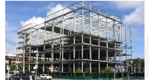
Долгострой г. Тюмень, ул. Пермякова, 2г.
